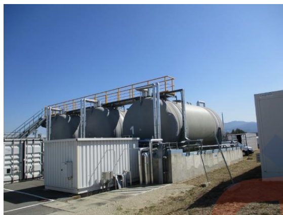
Figure C : Cuves tampons de la station NEPTUNE avant rejet dans l'Isère
